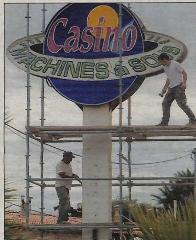
Sur l'échafaudage, les ouvriers sont en train d'aménager l'enseigne. (Photos Dominique Leriche)
