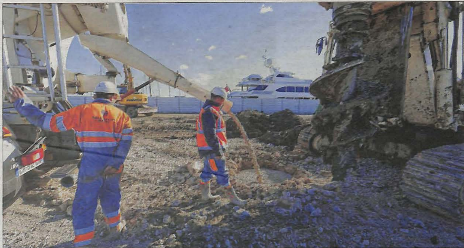
Sur le site des anciens chantiers, entre le parc de la Navale et l'Esplanade marine, l'heure est à la pose des soixante pieux qui soutiendront le bâtiment casino, à vingt mètres de profondeur. (Photos Dominique Leriche)
