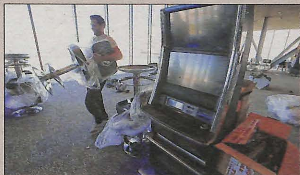
La salle des machines à sous, en cours d'installation au 3 e étage du bâtiment.
