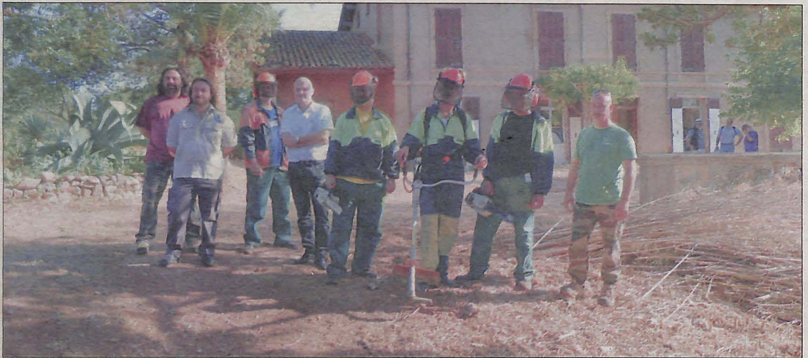
Outils en main, les participants, entourés de Claude Astore et d'équipe encadrante, ont achevé le chantier hier.
