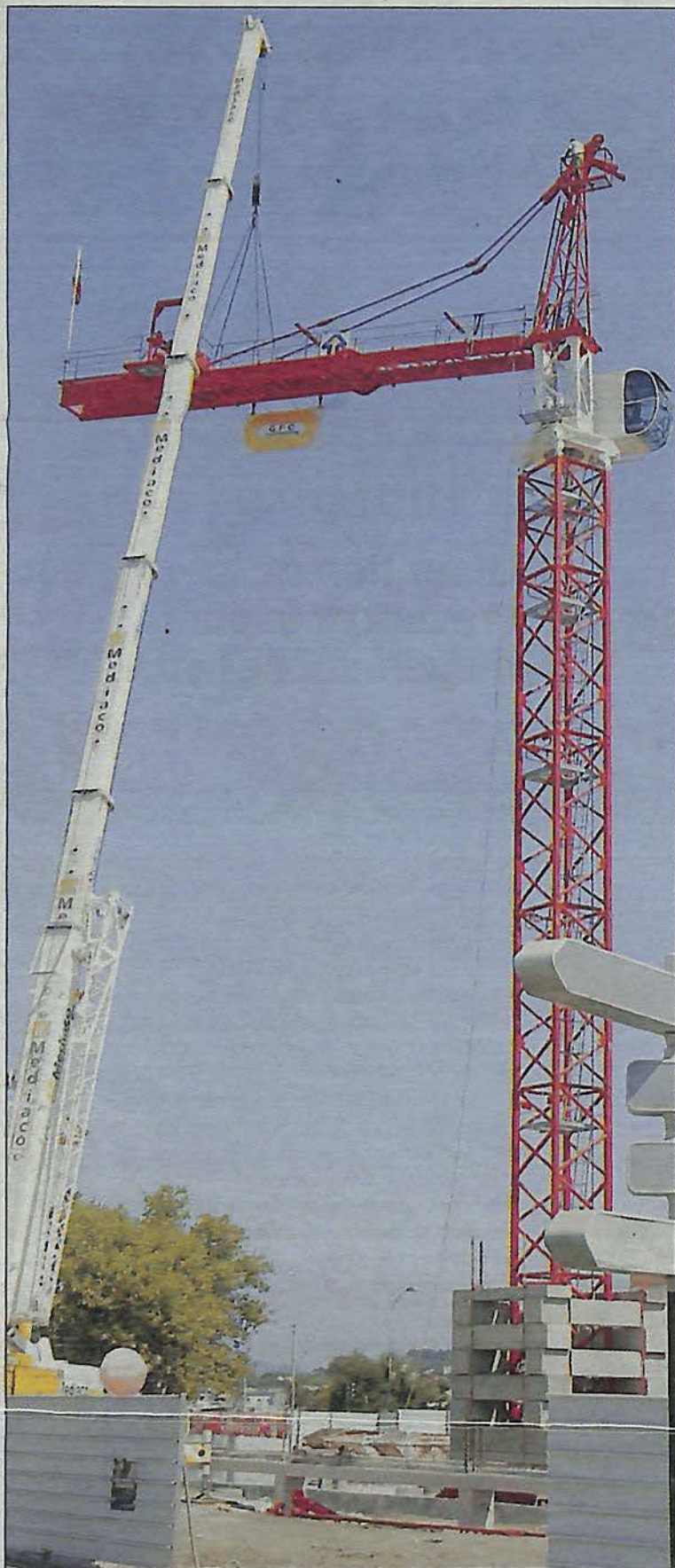
Le futur parking des Esplageolles, de 400 places sur quatre étages, devait être livré à l'été 2010. Mais les travaux sont définitivement arrêtés, et la grue a été démontée hier. (Photo Dylan Meiffret)
