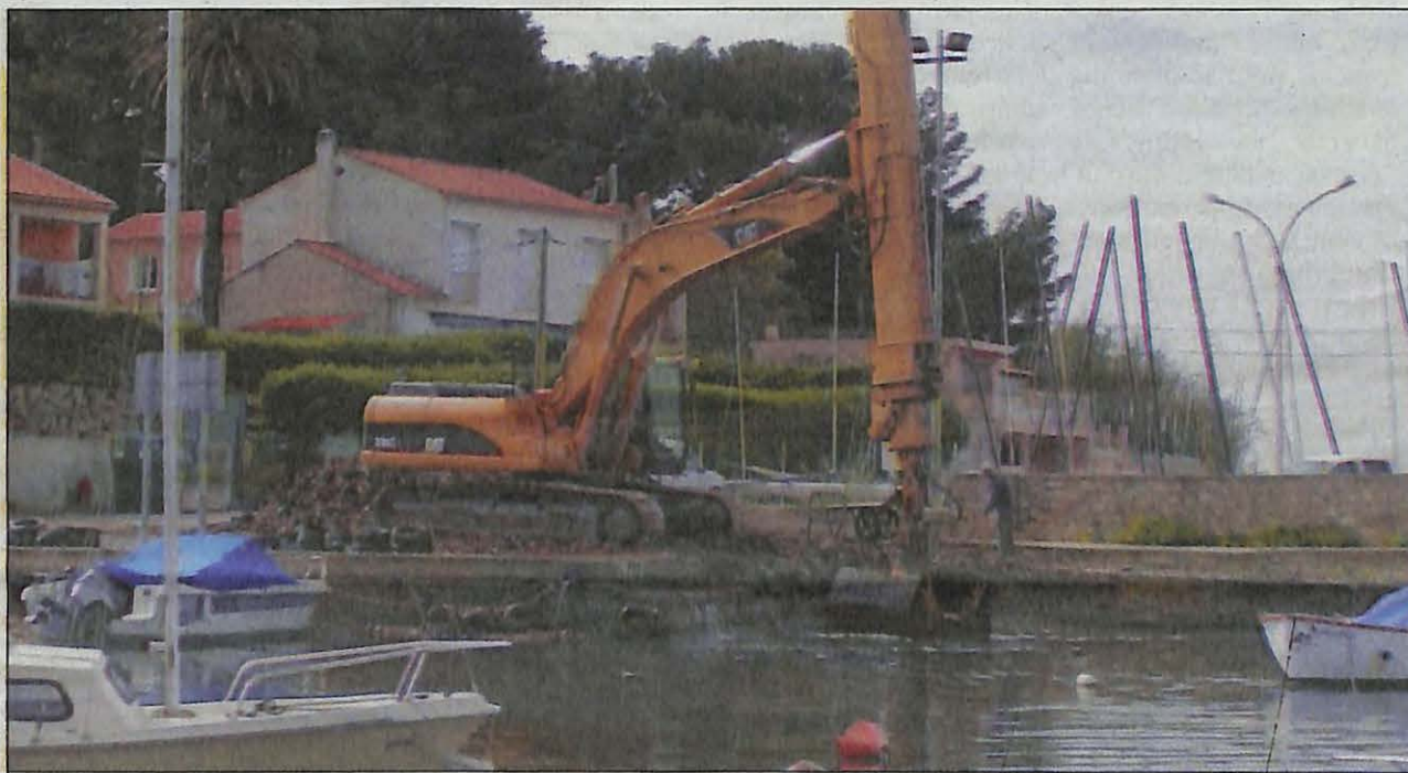
Lors de l'opération de dragage, le quai s'est affaissé au niveau des buses. selon un expert, cette partie du port est irréparable. (Photo D. L.)
