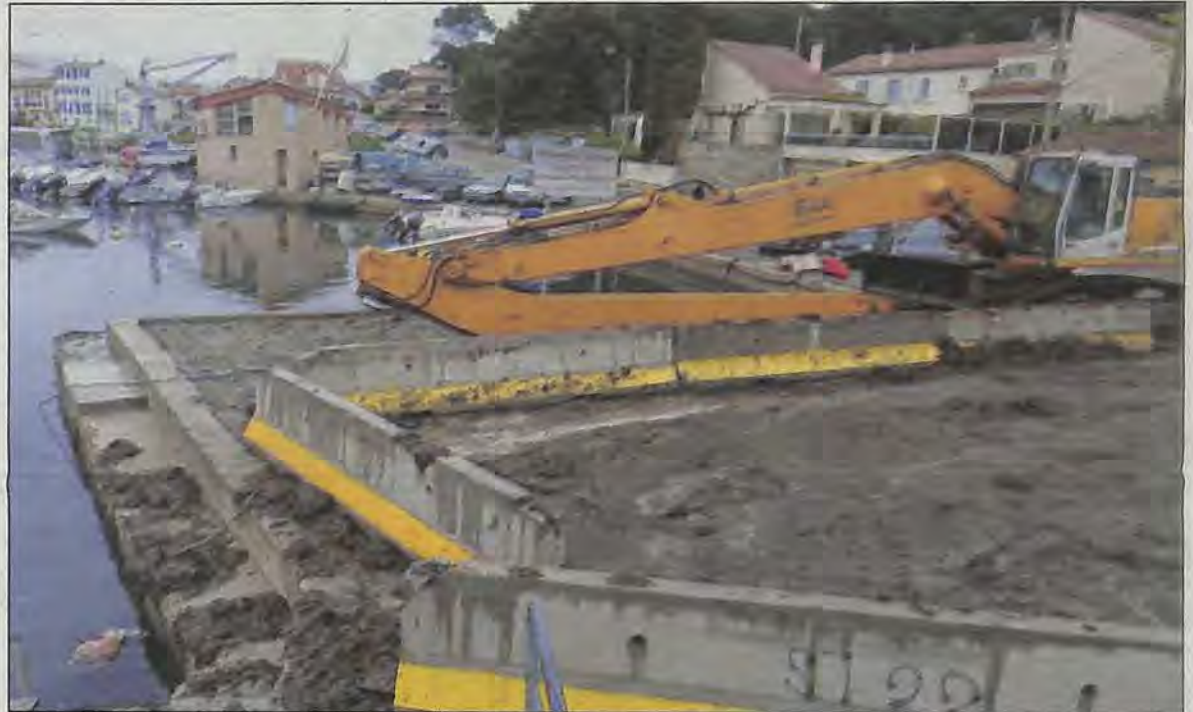
Le courant généré par les pompes n'ayant pas réussi à décoller la masse des posidonies accumulée au fond du bassin, l'autorité portuaire revient au traditionnel nettoyage à la pelleteuse. (Photo C.G.)
