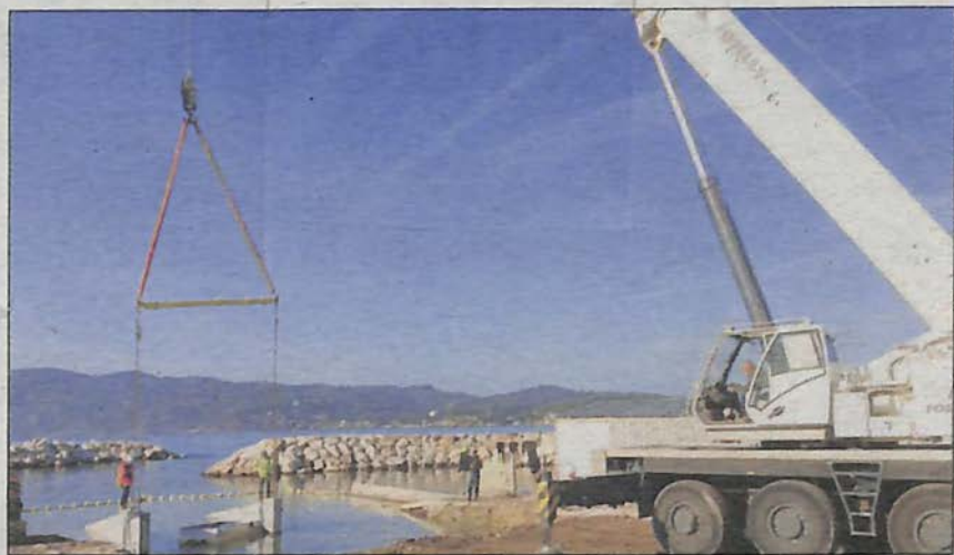
Une grue de 30 tonnes est utilisée pour positionner les blocs en béton qui vont structurer le chenal d'avivement.
