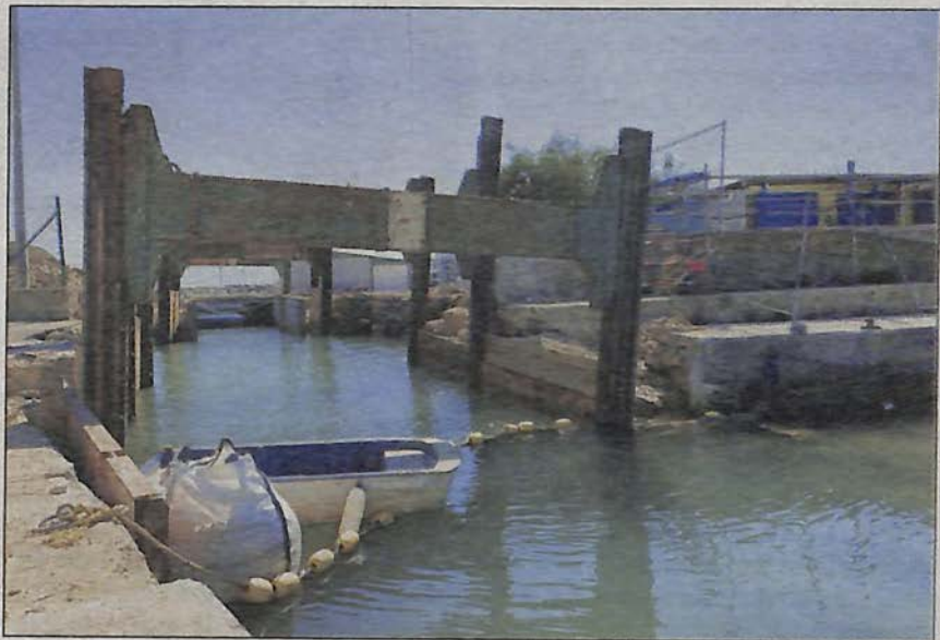
Vue du côté nord : le bassin du port communique désormais avec la mer.
