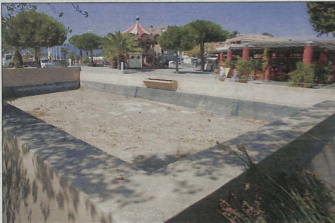
Aujourd'hui, le bassin du parc Braudel est vide. Une fuite d'eau rend son remplissage inutile. Mais bientôt, la ville pourra débiter des travaux de réparation. (Photo Dominique Leriche)
