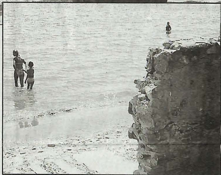
Laisser la plage ouverte au public s'avère trop dangereux au vu de ces blocs qui menacent de tomber.
