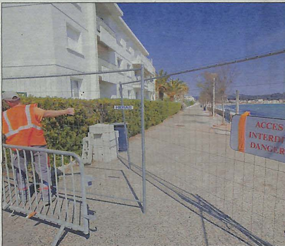
L'accès à la promenade Charcot est fermé depuis décembre dernier. Hier, les sondages du mur de soutènement ont été effectués. Les travaux devraient durer de deux à trois semaines. (Photo Dominique Leriche)
