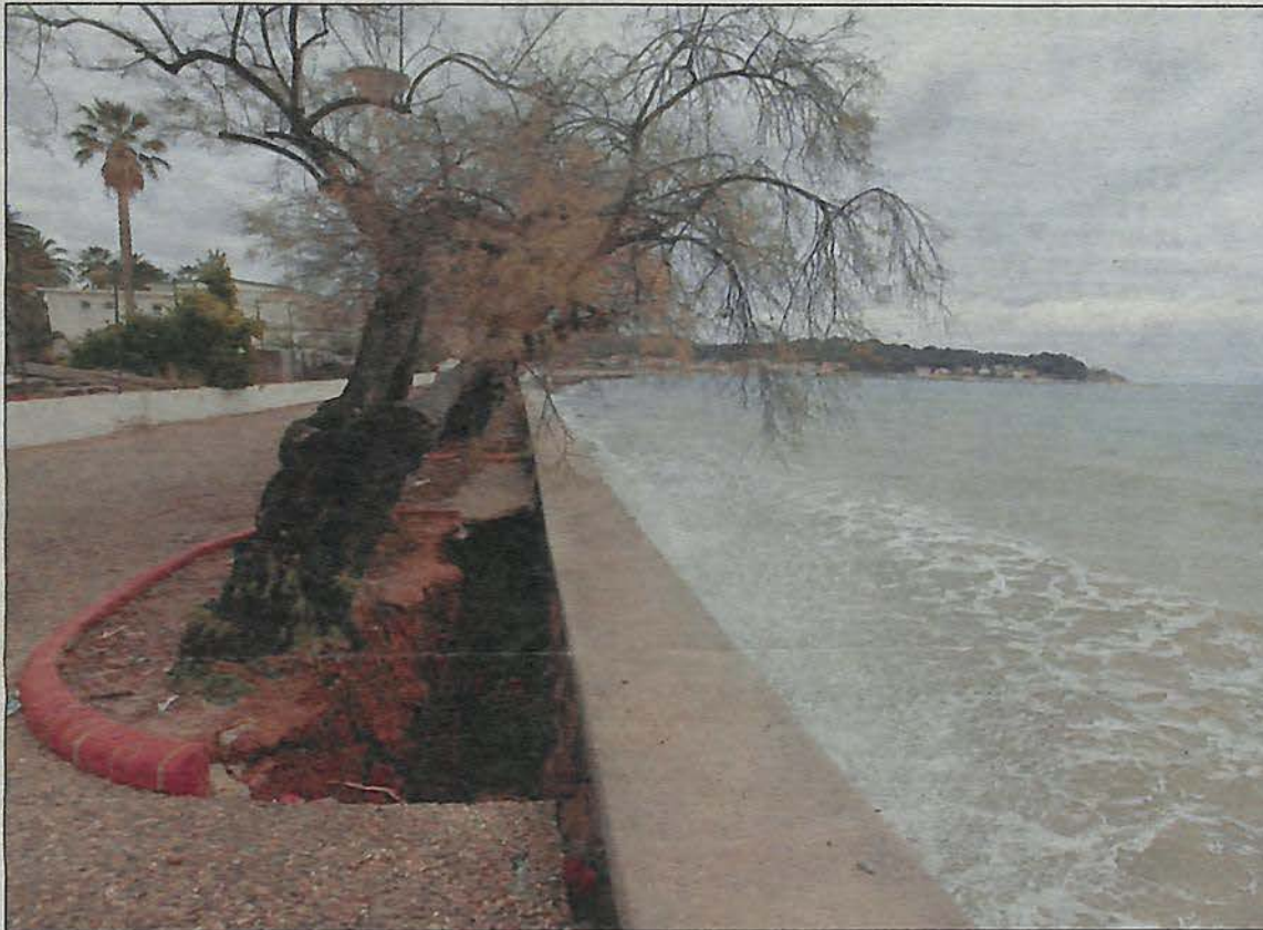
En décembre 2009, une partie du mur et le vieil escalier de la promenade s'étaient écroulés sous la puissance des vagues qui avaient raviné le sable. La promenade avait été fermée pendant plusieurs semaines avant de rouvrir provisoirement pour l'été. (Photo doc M. R.)
