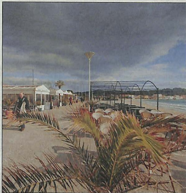
Dans quelques jours, la promenade Charcot, aux Sablettes, mise à mal par les intempéries de novembre 2009, fera l'objet de travaux de confortement définitif. (Photo Dominique Leriche)
