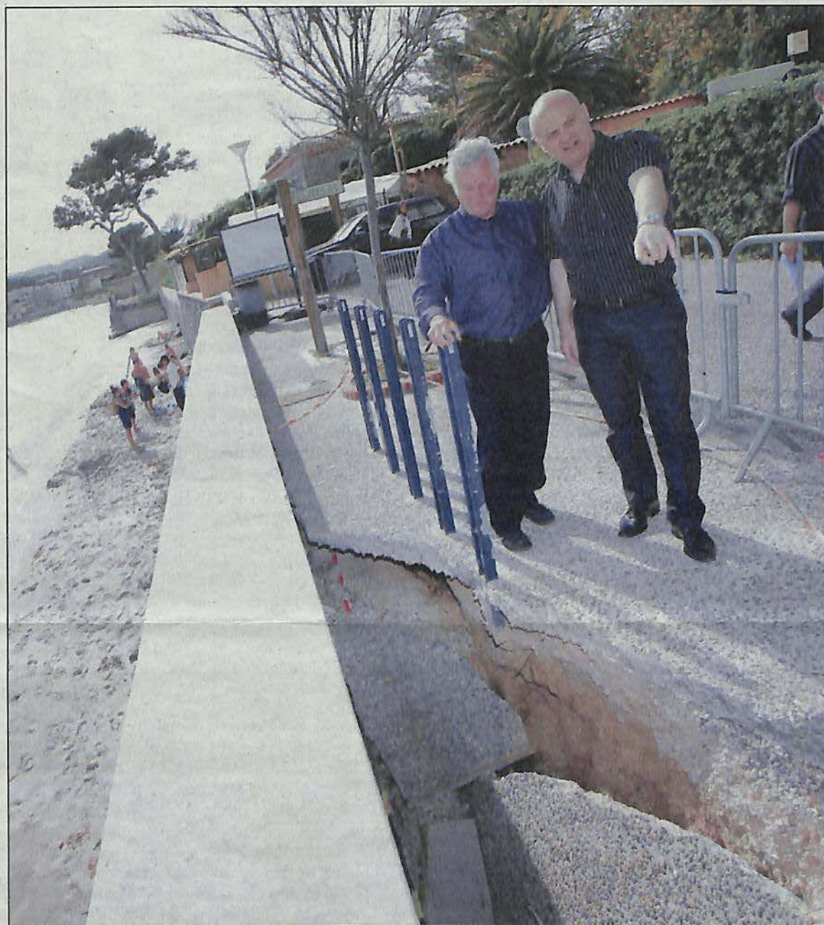
(De gauche à droite) Claude Astore, adjoint aux travaux, et Alain Lopez, adjoint délégué aux quartiers sud, montrent les dégâts causés par la dernière largade le long du mur de soutènement de la promenade Charcot, aux Sablettes. (Photo David Latour)
